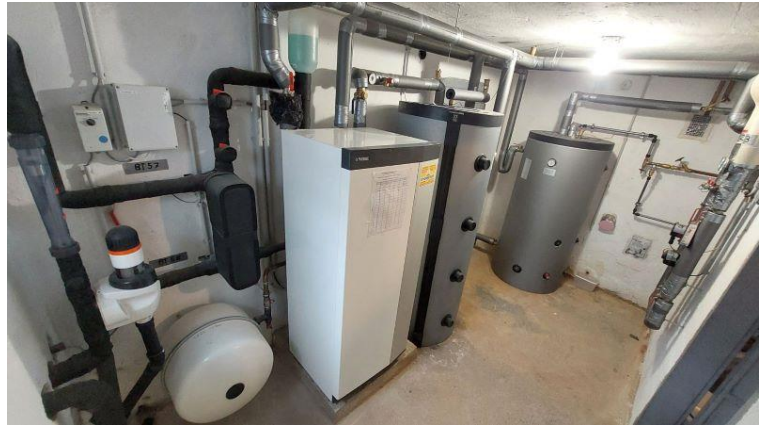
Ansicht der neuen Heizanlage
